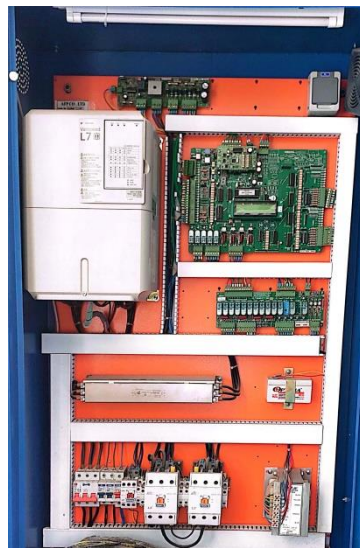
تصویر (۱-۵) تابلو فرمان آسانسور
